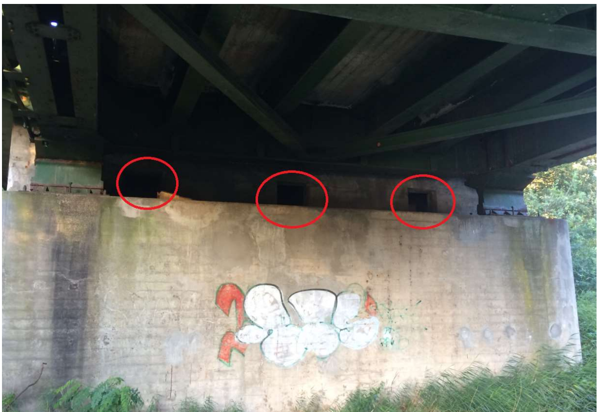
Figuur 2: Impressie van de inspectieopeningen in de bruggenhoofden. Hier het oostelijke bruggenhoofd waarin alle drie de afsluitluiken voor de inspectieopeningen ontbreken.
