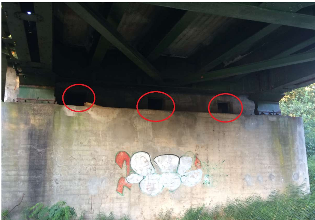
Figuur 4.1.8: Ontbrekende inspectieluiken in de bruggenhoofden, waardoor vleermuizen toegang kunnen krijgen tot de interne ruimten in de bruggenhoofden.
